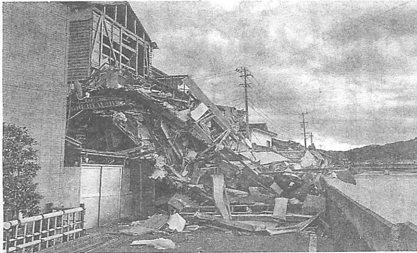
地震で倒壊した家屋＝1月2日、石川県輪島市（證史朗さん撮影）
